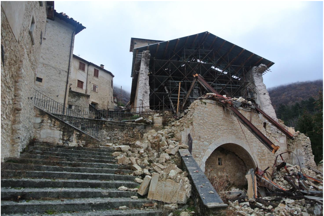
Figura 9. Foto della chiesa di Sant'Andrea dopo il sisma del 2016
